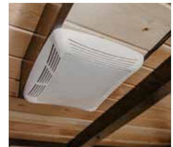
EXHAUST FAN & LIGHT
